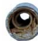
Rohrleitung 10 Jahre alt
